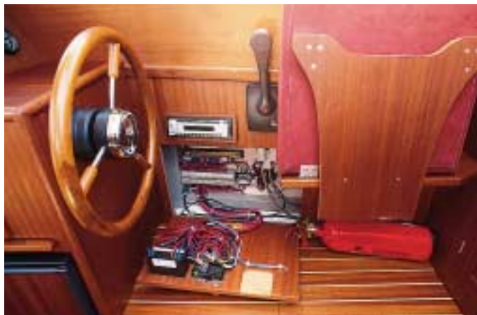
Für die Kontrolle: Der Schaltkasten lässt sich ganz einfach nach vorn klappen – zur Inspektion oder zum eventuellen Nachrüsten
